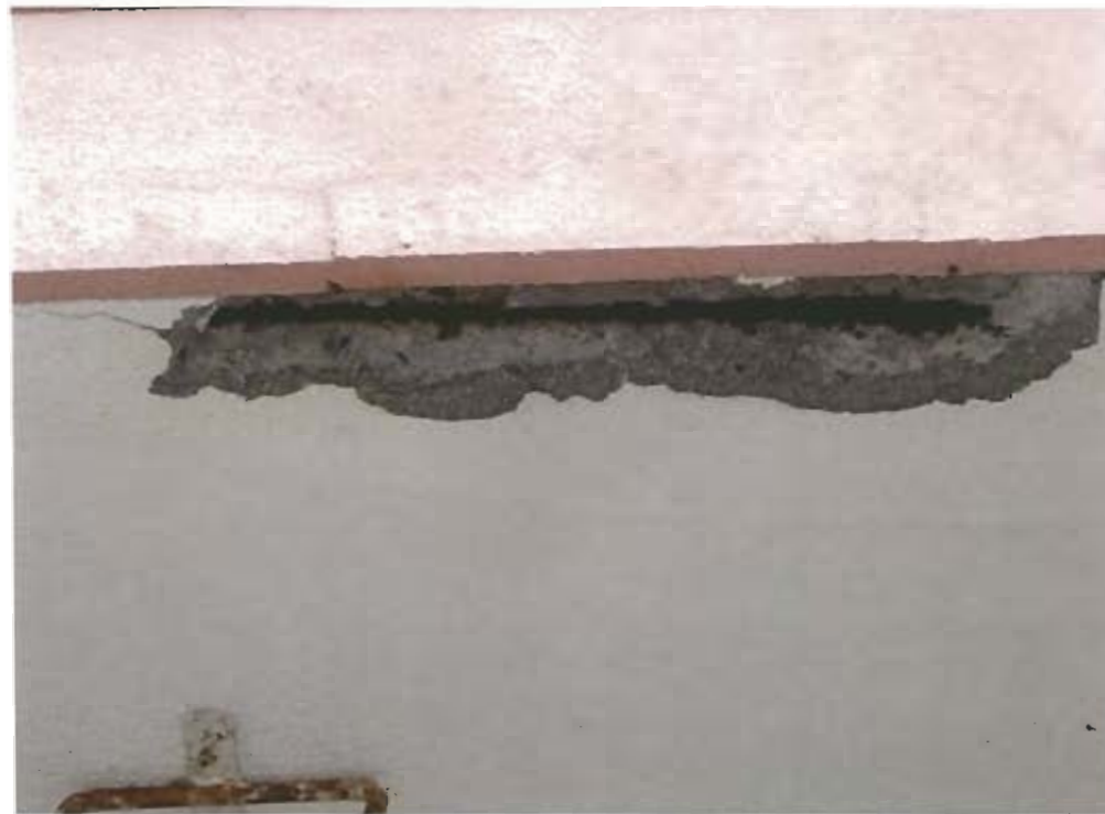
内部鉄筋の爆裂
