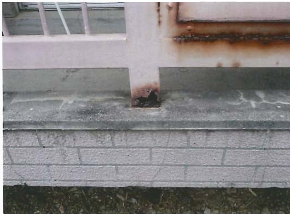
鉄部の発錆・腐食
