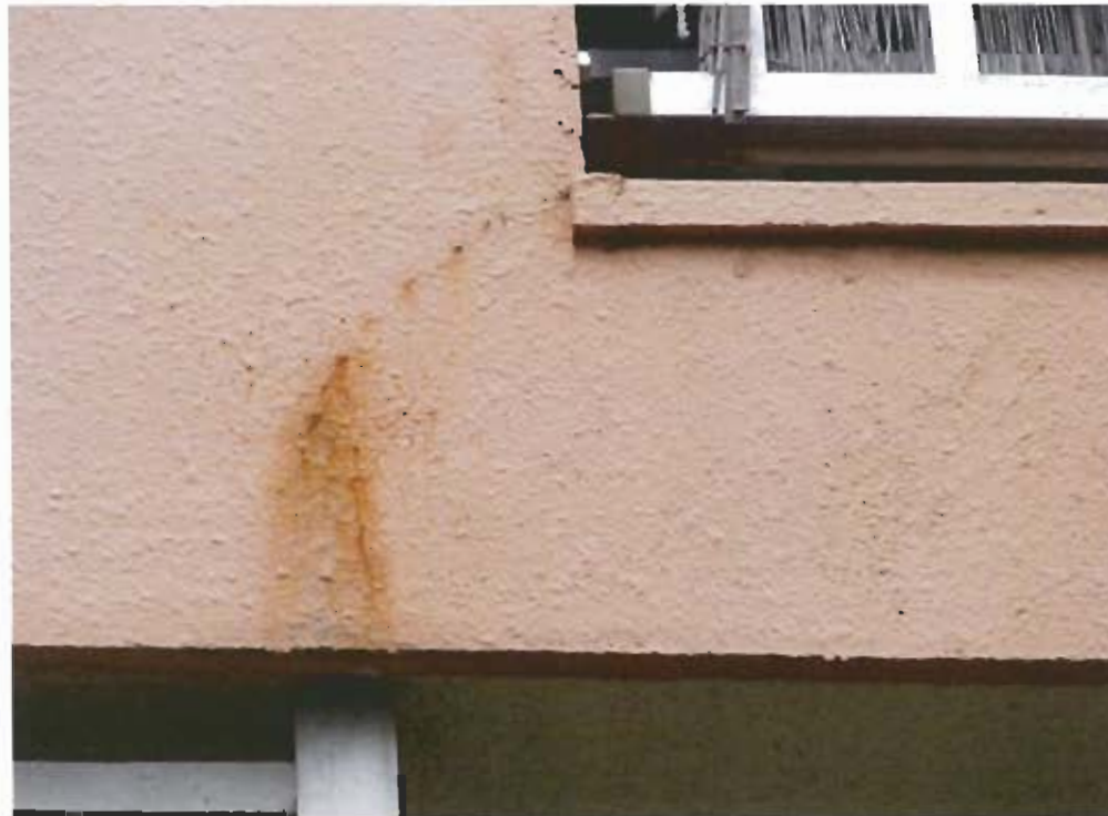
内部鉄部からの錆汁
