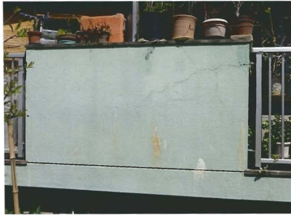
躯体もしくはモルタルのひび割れ
